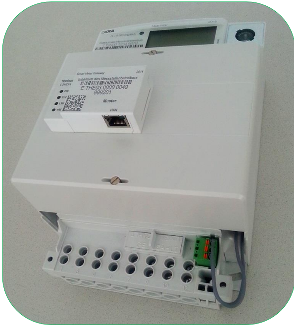
Bild 44: Zähler mit montierten SMGw und Moduldeckel. Richtige Position und Länge von Power Kabel
